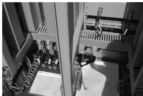
图 3 智能柜内电缆、光缆连接情况
