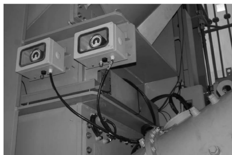
图 2 控制线路全部镶嵌在变压器的箱壁上
